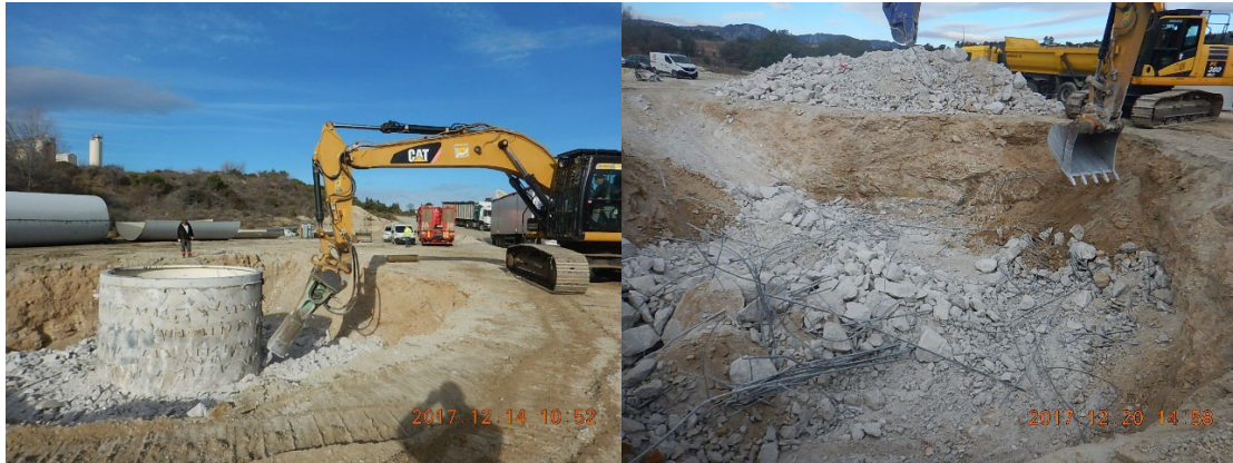
Figure 4- Destruction de la fondation
